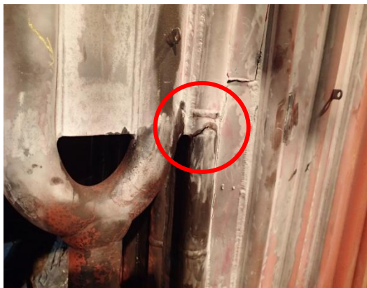
1号機：ボイラー管損傷状況
