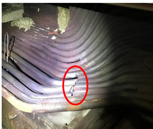
2号機：ボイラー管損傷状況①
